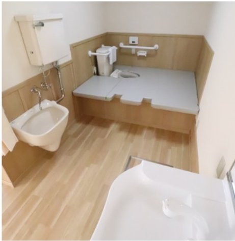
頸椎損傷者専用のトイレです。 移乗台の高さは500mmに設定しており、車椅子からの乗移もスムーズに行えるように考えました。
